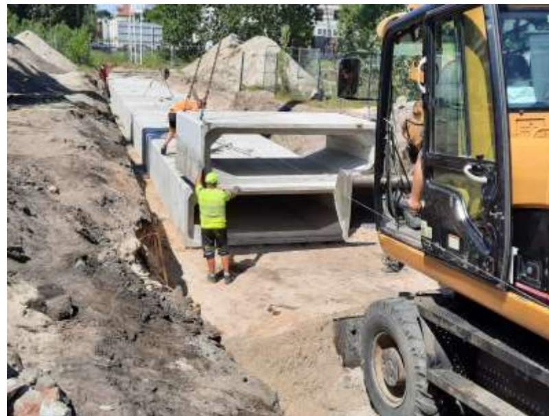
Retencja kanałowa przy ulicy Leśnej (materiał – żelbet szerokość 3,0 m, wysokość 0,75 m, długość 45 m, pojemność 95 m 3 )
