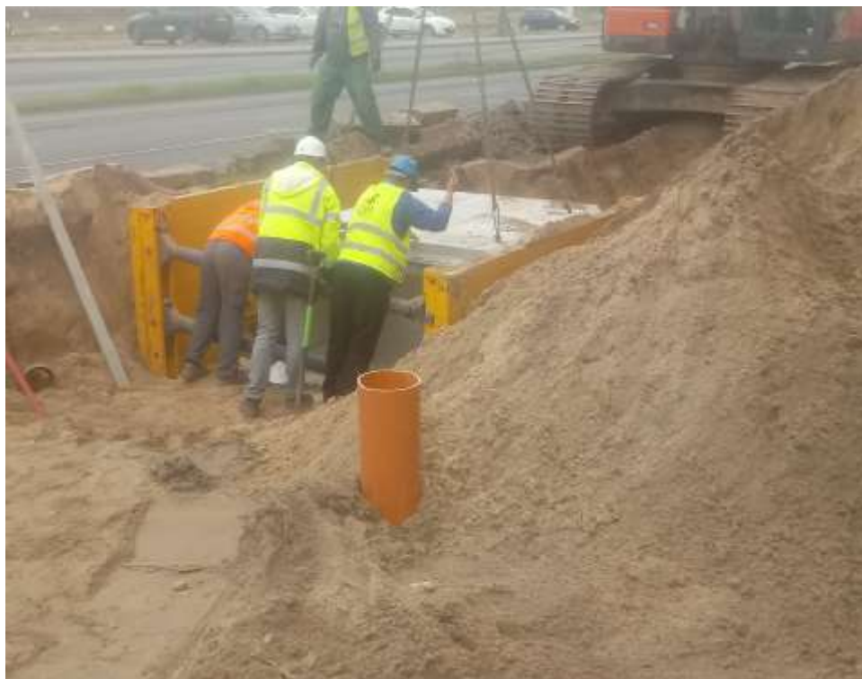
Retencja kanałowa przy ulicy Zygmunta Augusta (szerokość 1,5 m, wysokość do 1,0 m, długość 177 m),
