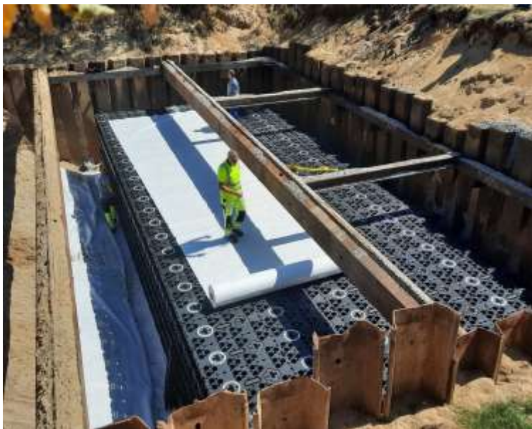
Zbiornik ze skrzynek rozsączających przy ulicy Kasztelańskiej (materiał – tworzywo sztuczne, pojemność 567 m 3 )
