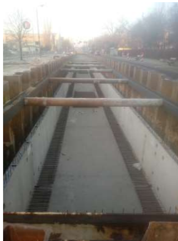
Retencja kanałowa przy ulicy Skłodowskiej – Curie (długość 81 m, szerokość 4,0 m, wysokość do 2,0 m)
